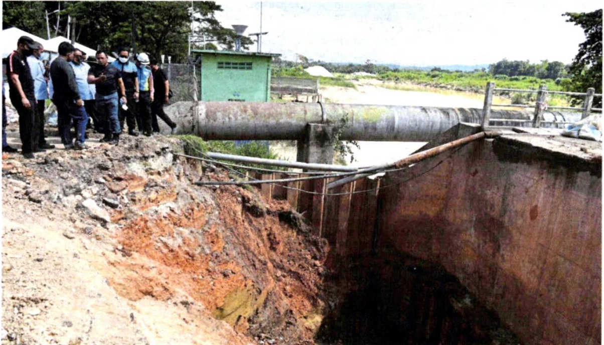
AMIRUDIN (tiga dari kiri) meninjau kerja-kerja membaik pulih jambatan Dengkil di Sungai Langat yang runtuh akibat hakisan air sungai.
