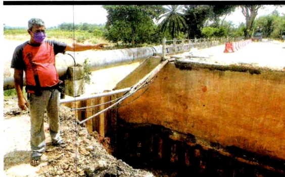
MOHD. AZMAN menunjukkan Jambatan Pekan Dengkil yang menghubungkan laluan Banting-Dengkil runtuh semalam.
